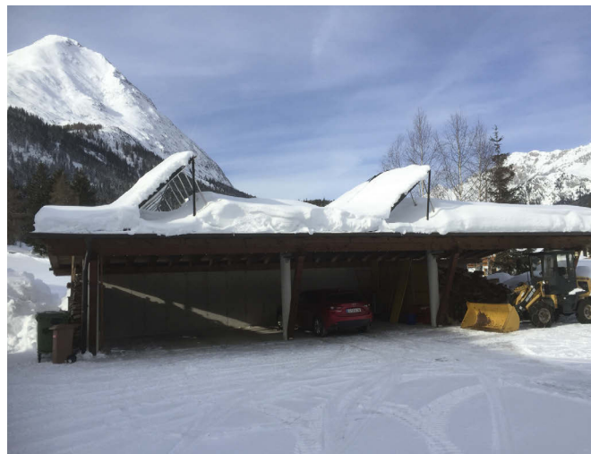
Abb. 7: PV-Module auf Garagendach in den Alpen.
