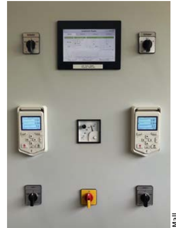
Untergebracht im Freiluftschrank: Anhand kontinuierlicher Durchflussmessung wird die Pumpendrehzahl an das vorgegebene Einleitmaximum angepasst.
