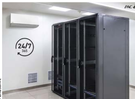
Redundanz schafft Sicherheit – das gilt auch für die Kühlung von EDV-Räumen.
